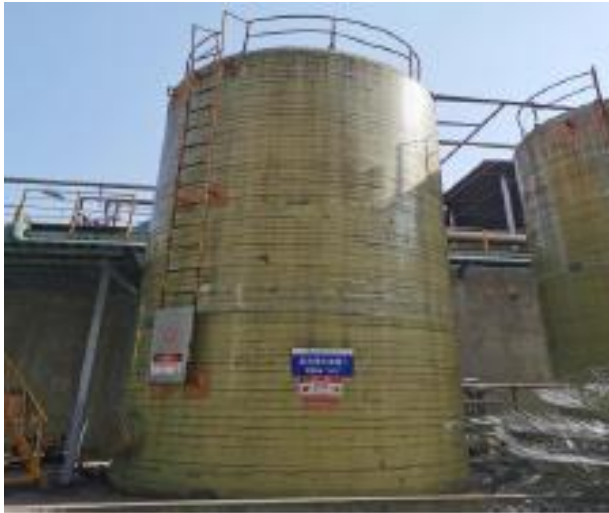
图2-21 高浓度废水储罐
