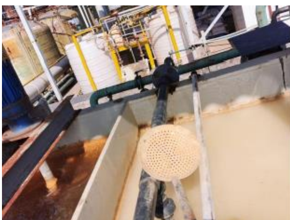
图2-25 物化后加絮凝剂的搅拌池
